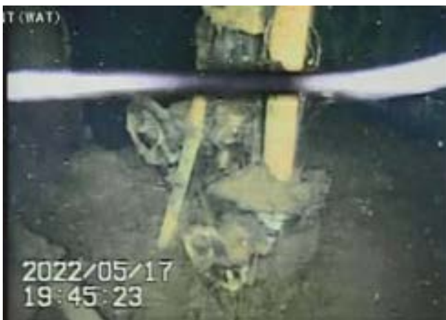
写真2 原子炉補機冷却系の弁
