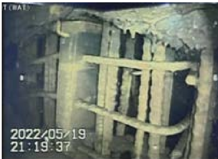
写真4 ペDESTAL開口部（左側）むき出しの鉄筋
