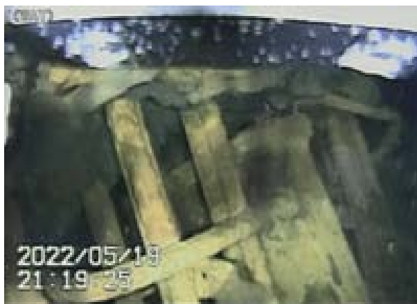
写真3 ペDESTAL開口部（右側）むき出しの鉄筋
