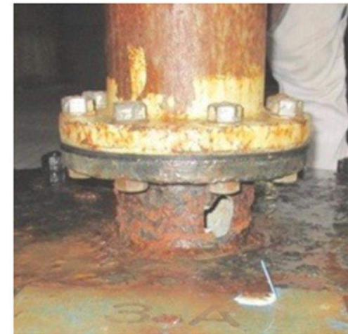
関西電力大飯原発3号機の配管にあった穴 = 4日 (関電提供)
