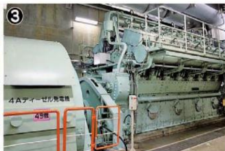
③ 非常用ディーゼル発電機(4台) 約8,900kVA/台 *台数は大飯発電所3、4号機の合計
